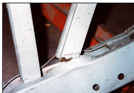
Foto 6 Foto 6. Falla de la unión en la dirección arriostrada
