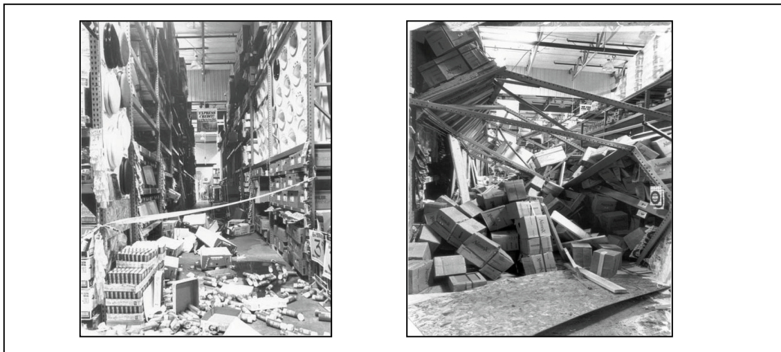
Fotos 1. Colapso por sobrecarga y caída de elementos en una sección del Home Depot Santa Clarita en California durante el terremoto de Northridge en 1994 [5] .
