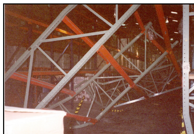
Foto 3. Falla súbita de una estantería por almacenamiento asimétrico.
