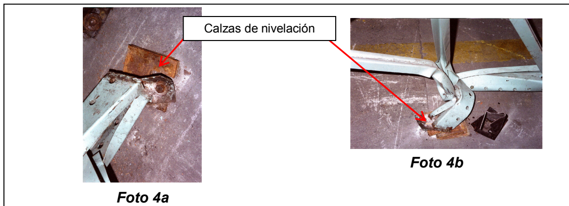
Fotos 4. Falla del anclaje al piso. Nótese que las platinas de ajuste (calzas de nivelación) reducen la eficiencia a los pernos de anclaje al disminuir su longitud de anclaje.
