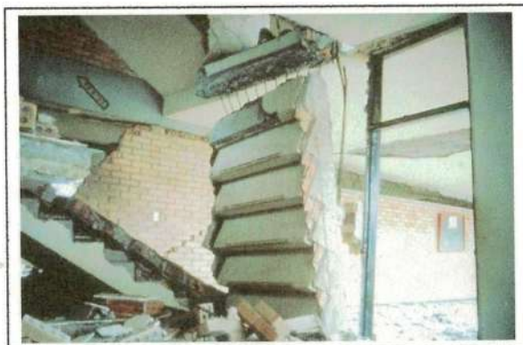
Daños en escaleras
