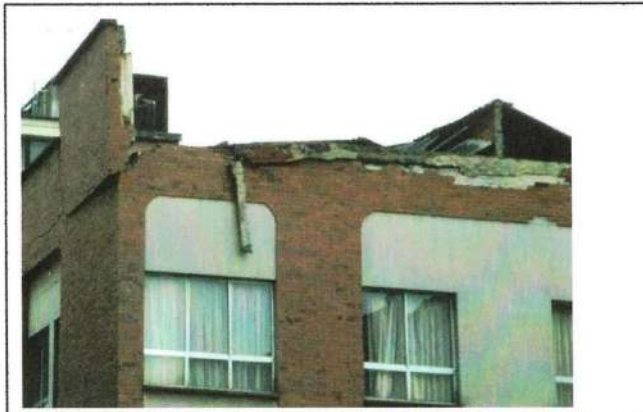
Daños en parapetos de ladrillo no reforzado
