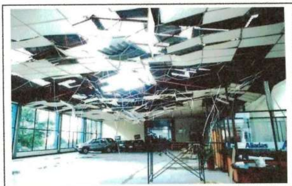
Daño en cielo raso
